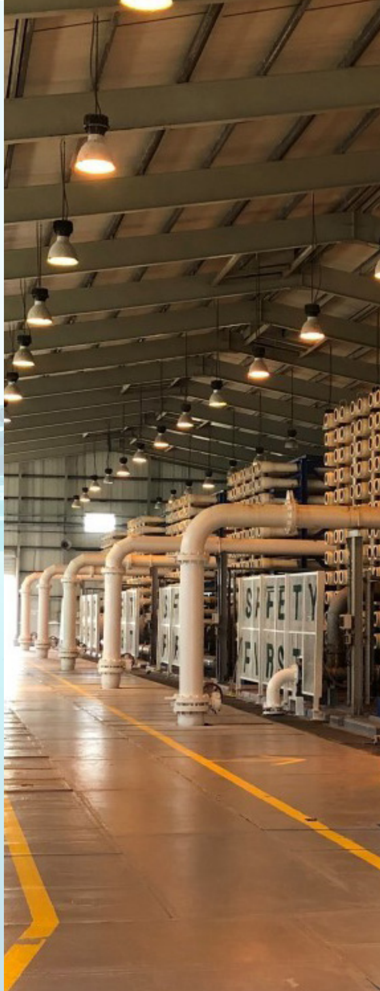
Planta desaladora del Aeropuerto Internacional Rey Abdulaziz, en Yeda (Arabia Saudí).
