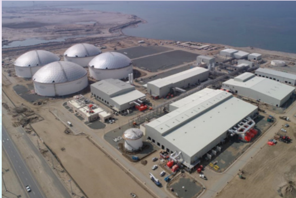
Desaladora y sistema de distribución del área industrial de Jizán (Arabia Saudí).
